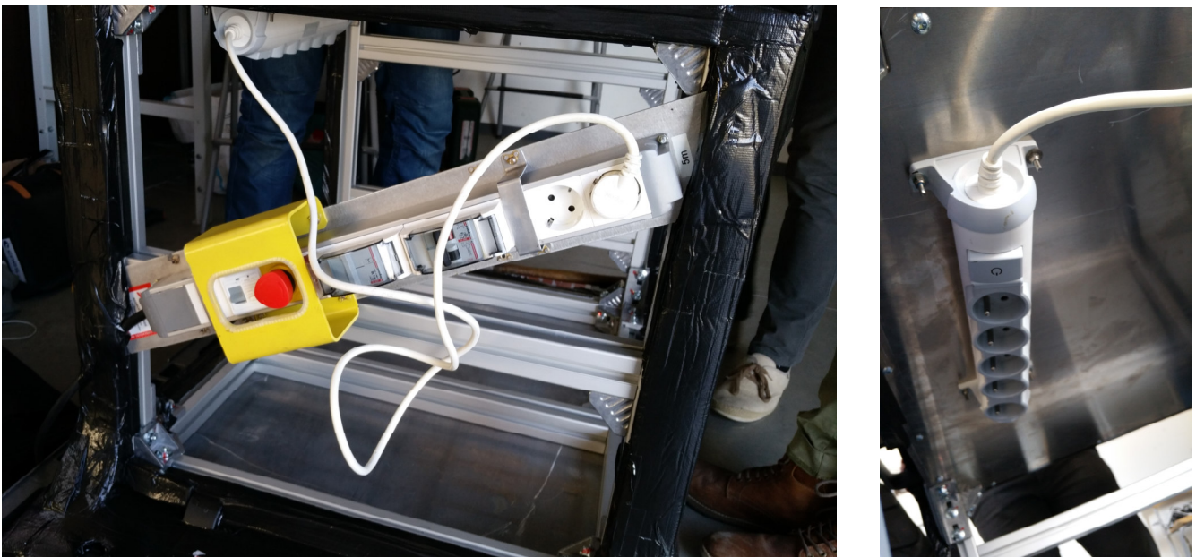
Figure 5 : Distribution électrique du caisson mécanique, la barre de distribution est fixée sur les profilés du caisson, une nourrice fixée sous la tôle abritant la partie mesure permet de brancher jusqu'à 5 prises
